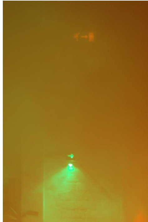
De twee vluchtrouteaanduidingen ter plaatse van de nooduitgang. Situatie met rook.
