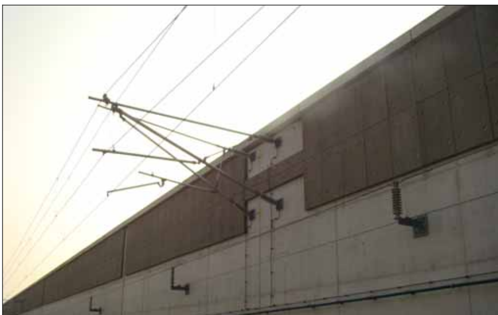
Afbeelding 7: de uithouder van de bovenleiding waar het slachtoffer dicht bij in de buurt is gekomen
