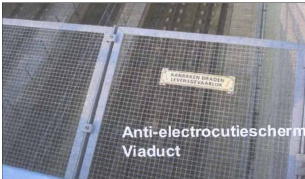
Afbeelding 5: het anti-elektrocutescherm met waarschuwingsbord aan de spoorzijde van het tunneldek.
